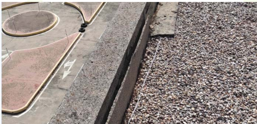
Deterioro de la impermeabilización
