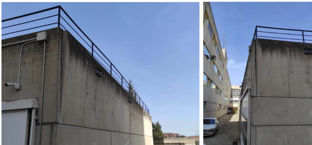
Vuelco y atirantamiento de algunos paneles de cubierta
