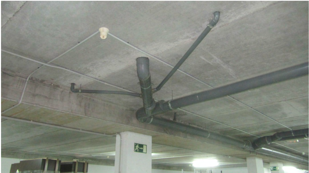
Tuberías y colectores de recogida de aguas de pluviales y fecales para su conexión con la red municipal
