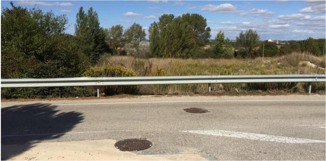
3. Pozos de registro de pluviales y residuales en semiglorieta de acceso a Cortes.
