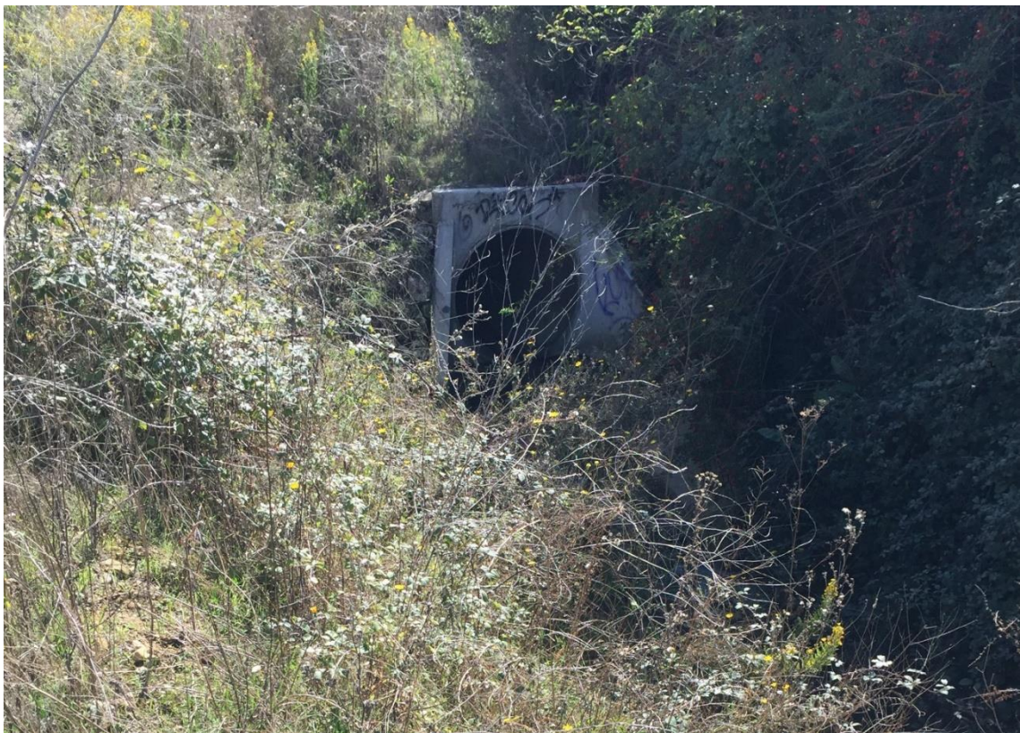
4. Vertido de pluviales a cauce abierto.
